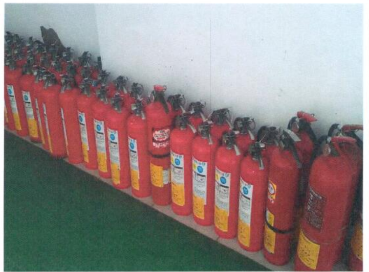
地點：各班教室 時間：104.9.15 說明：消防與指示等器材完成檢整並紀錄備查。
